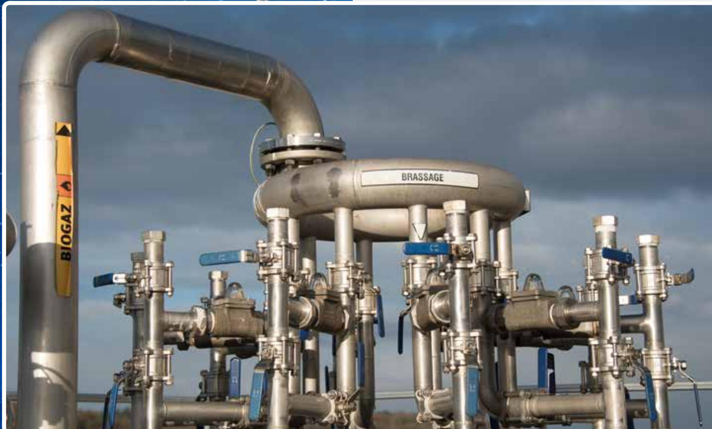
La valorisation du biogaz permet de produire de l'électricité
